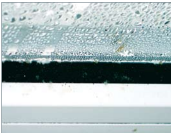
Znaczne ryzyko kondensacji pary wodnej i powstawania pleśni przy zastosowaniu zwykłych, aluminiowych ramek dystansowych
